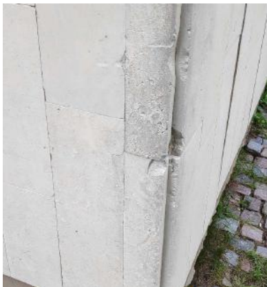
4.19.6.att. Ēkas dienvidu puses kāpņu telpas stūrī izdrupušas dolomīta plāksnes.
