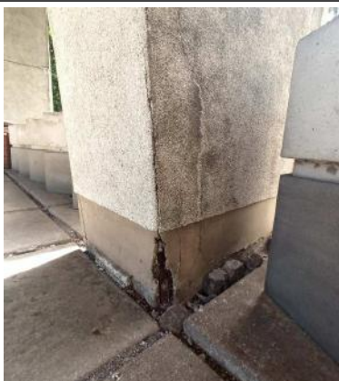
4.3.6.att. Ārējai monolītā dzelzsbetona kolonnai konstatēts dekoratīvā apmetuma izdrupums.
