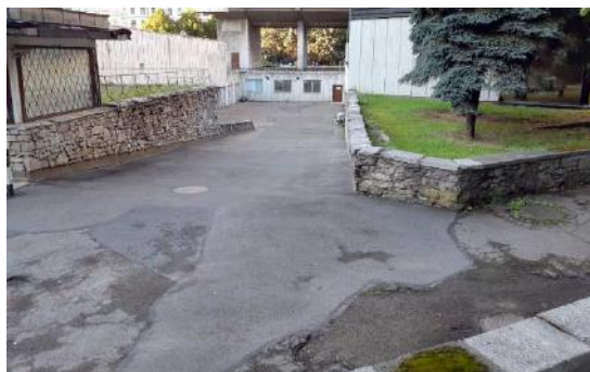
3.1.4.att. Rampa uz ēkas tehniskajām ieejām pagrabstāvā. Atbalstsienas apdrupušas, taču noturību pagaidām saglabā. Dažādi defekti asfalta segumā.
