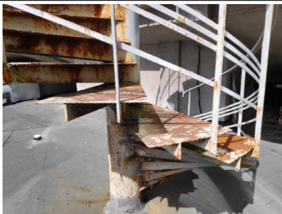
4.10.17.att. Daži kāpņu tērauda lokšņu pakāpieni ir deformējušies.
