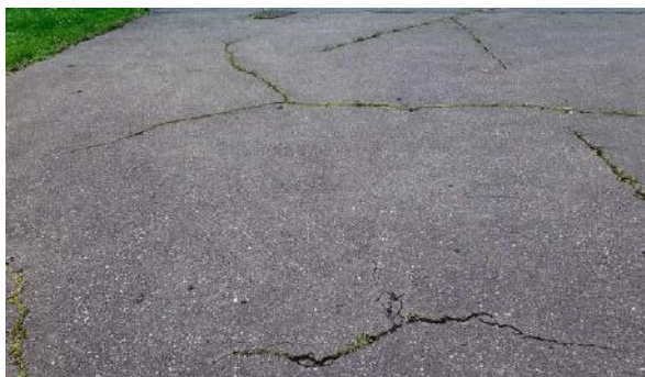
3.1.5.att. Apgrīšanās laukums pie ēkas D spārna, asfalta segumā apjomīgas plaisas.
