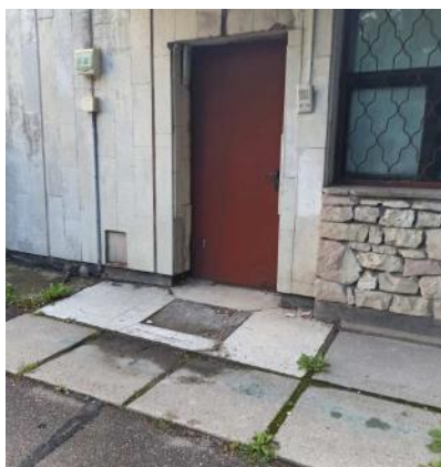
4.10.21.att. Panduss pie ieejas ir saplaisājis un ar betona izdrupumiem. Neapmierinošā stāvoklī.
