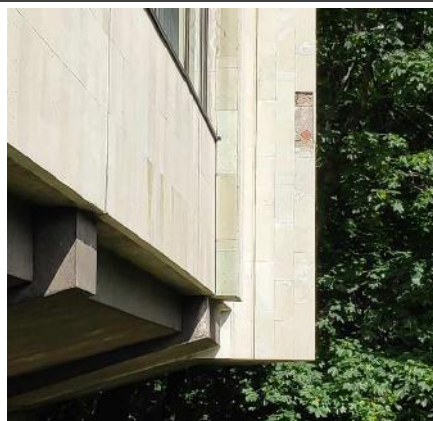
4.19.2.att. Atdalījušās dolomīta plāksnes un plākšņu šuves izdrupušas. Prognozējama arī apkārt esošo plākšņu atdalīšanās nākotnē.
