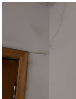
4.11.2.att. Konstatēta plaisa ķieģeļu mūra nenesošā starpsienā 1.stāvā telpā Nr. 97.
