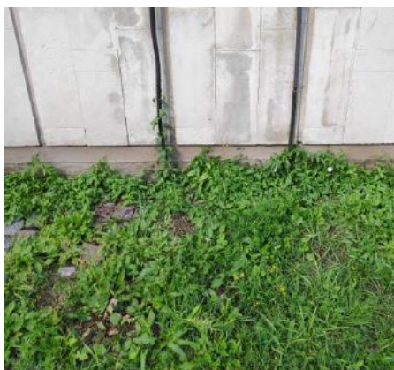
4.1.3. att. Ēkas D puses kāpņu telpas sienu apmale no akmens bruģa apaugusi ar zāli un sūnām.
