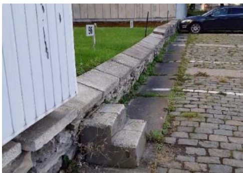
3.4.1.att. Atbalstsienas R stāvlaukumā pirms avārijas stāvoklī – iespējama tās apgāšanās.
