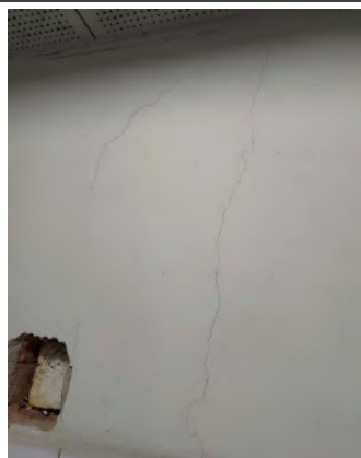
4.11.4.att. Konstatētas plaisas ķieģeļu mūra starpsienā telpā Nr. 97. Siena neapmierinošā stāvoklī.
