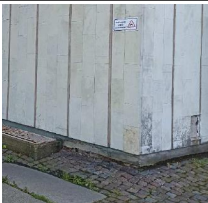
4.1.1. att. Ēkas ZA puses stūrī apmale pie sienas deformējusies.
