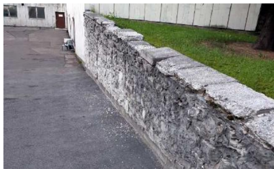
3.4.2.att. Konstatēts atbalstsienas virsējā apšuvuma plātņu neapmierinošs stāvoklis
