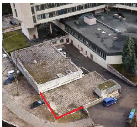
4.8.10.att. Jumtam nav izvietotas aizsargbarjeras kā rezultātā uz jumta var uzbraukt autotransports – tādām slodzēm jumts nav paredzēts.
