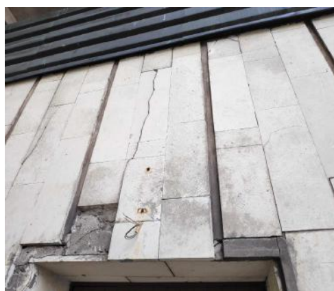
4.19.5.att. Dolomīta plāksnes saplaisājušas un atdalījušās. Prognozējama arī apkārt esošo plākšņu atdalīšanās nākotnē.
