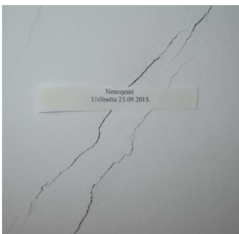
4.4.7.att. 6.stāvā telpā Nr. 15 pēc inventarizācijas lietas 2015.gada septembrī izvietotas plaisu monitoringa uzlīmes. Plaisas laika posmā no 2015.g. septembrim līdz 2020.g. augustam turpinājušas progresēt – periodiski plaisas “atverās” un “aizverās”.
