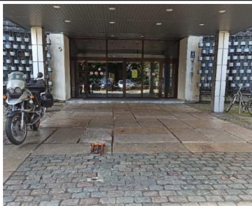
4.3.7.att. Pie galvenās ieejas ēkā izbūvētas 4 kolonnas, kas balsta ieejas jumtu. Kolonnas apšūtas ar skārda loksnēm.
