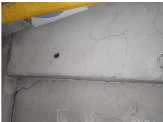
4.3.8.att. 7. stāvā (tehniskais stāvs) konstatēta pārseguma siju plaisāšana un sienu paneļa plaisāšana zem sijām.
