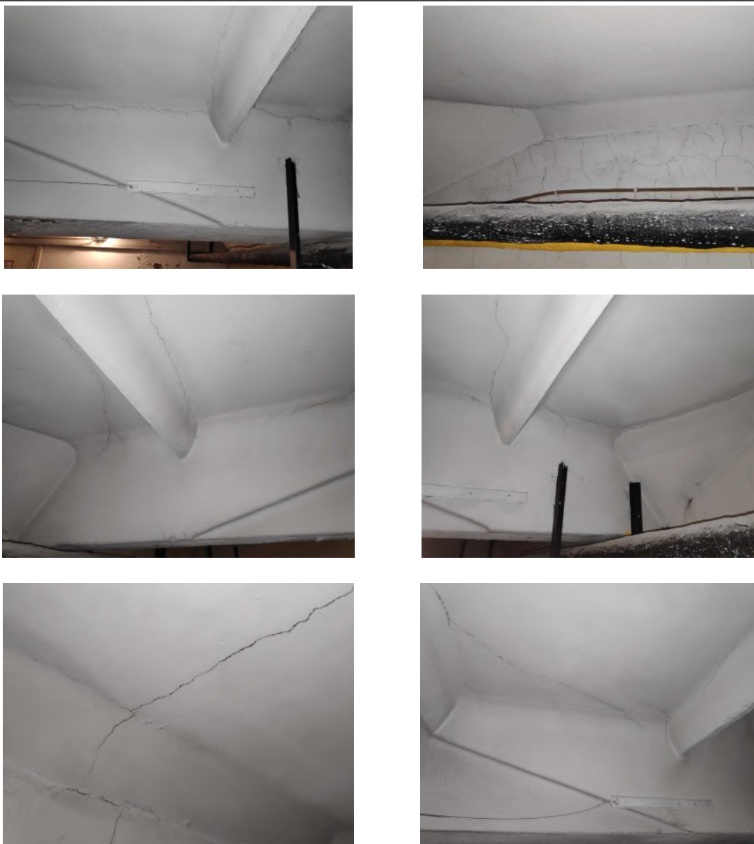
4.6.10.att. Lielākajai daļai 7.stāva pārseguma paneļu balsta daļā konstatētas plaisas. Pēc to rakstura var secināt, ka paneļi ir ar pārāk mazu bīdes jeb šķērsspēka nestspēju, lai uzņemtu esošās slodzes.
