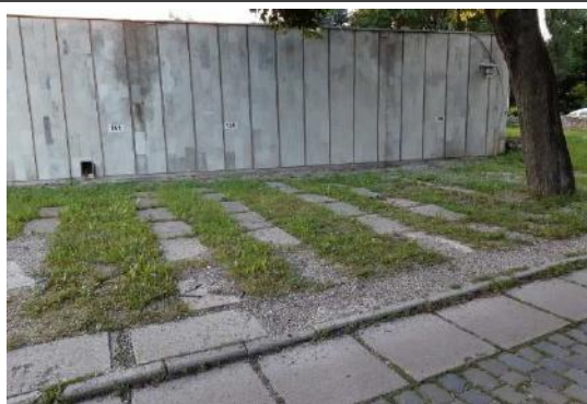
3.1.8.att. R stāvlaukums, DR gals, skats DA virzienā. Stāvvietas iekārtotas zaļajā zonā uz nelīdzena, daļēji sabrukušā joslveida dzelzsbetona plātņu seguma.
