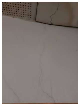
4.11.5.att. Konstatētas plaisas ģipškartona starpsienā virs durvju aillas telpā Nr. 97. Siena neapmierinošā stāvoklī.
