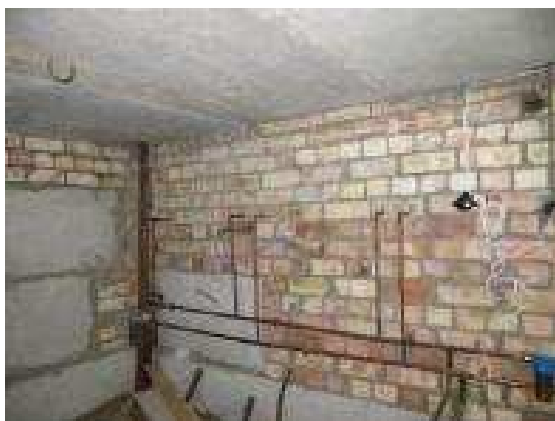
4.2.3.att. Pagrabā nesošās sienas no saliekamā dzelzsbetona pamatu blokiem un ķieģeļu mūra.
