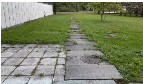
3.1.7.att. Ietve ar dzelzsbetona plātņu segumu ēkas DA pusē, skats A virzienā. Plātnes stipri iesaugušas zālē.
