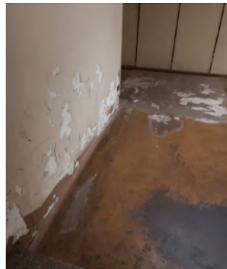
4.12.12.att. Pagrabstāvā telpā Nr.79 bojāts grīdas segums.
