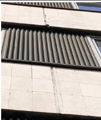
4.19.1.att. Sienas paneļu savienojuma vietā izdrupušas un atdalās dolomīta plāksnes.
