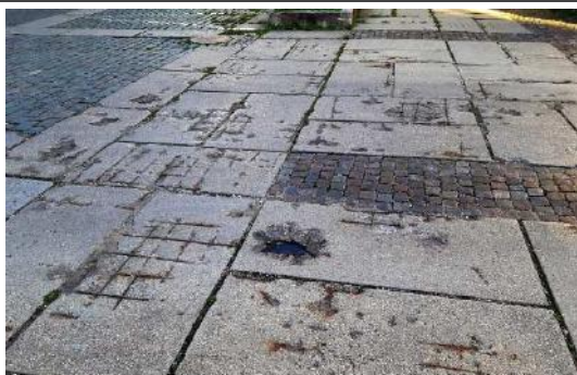
3.1.2.att. Plaši bojājumi dzelzsbetona seguma plātņu virsmā, atsegts stiegrojums.
