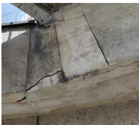
4.19.4.att. Fasādes plāksnes gals nolūzis un ieķīlējies blakus esošajās plāksnēs.
