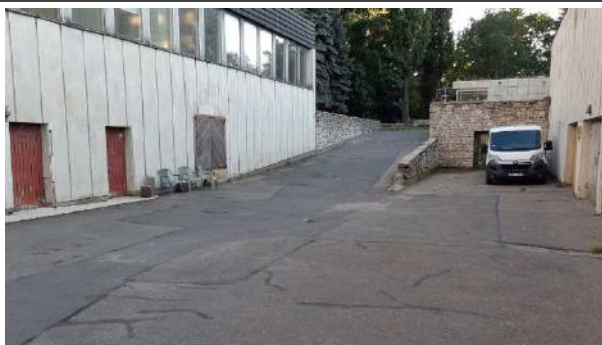
3.1.3.att. Skats uz rampu no apakšas. Plaisas asfalta segumā aizlietas.
