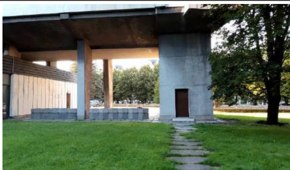
3.3.1.att. Ietve ar dzelzsbetona plātņu segumu zemes gabala A malā, skats Z virzienā uz ēkas ZA spārnu. Plātnes stipri ieaugušas zālē. Zem ēkas izvietotas betona puķu kastes; apsekošanas laikā bez augiem.
