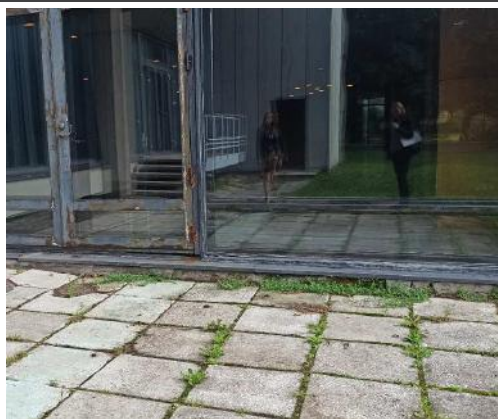
4.1.2. att. Ēkas DA puses malā apmale no betona plāksnēm deformējusies, betona plāksnes vietām pārlūzušas un ar izdrupumiem.
