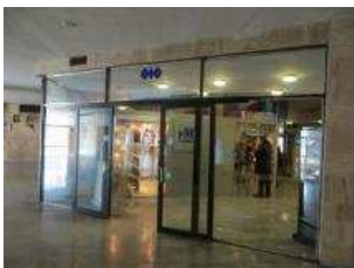
4.11.6.att. Alumīnija karkasa stiklotas starpsienas 1.stāvā, labā tehniskā stāvoklī.
